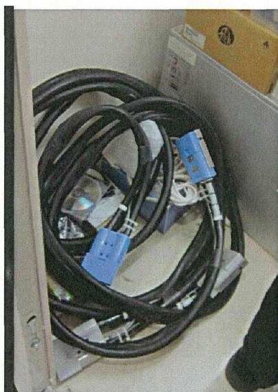
電源接続用ケーブル
