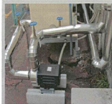
仙台整形外科病院 猪川訓志先生ご提供 写真1 仙台市宮城野区周辺施設 この地域周辺の施設では地盤沈下の被害が多く報告されている。
