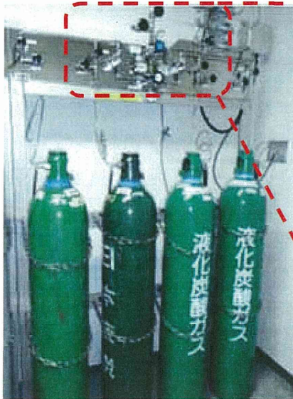
ボンベラック設置例
