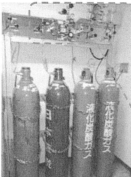
ボンベラック設置例
