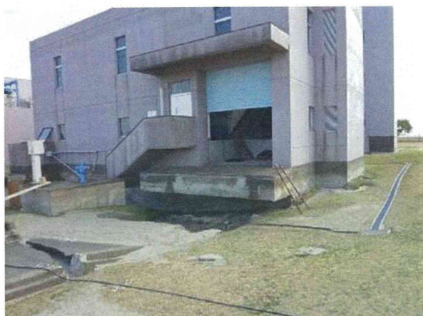
ポンプ室前の地盤沈下
