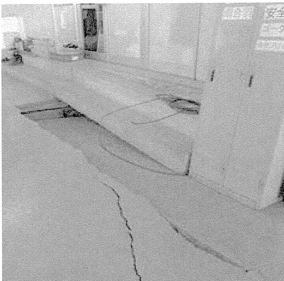
送水ポンプ室床版損傷
