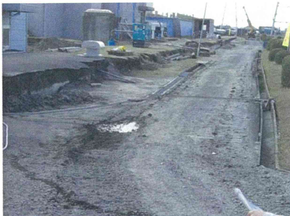
液状化に伴う地盤沈下
