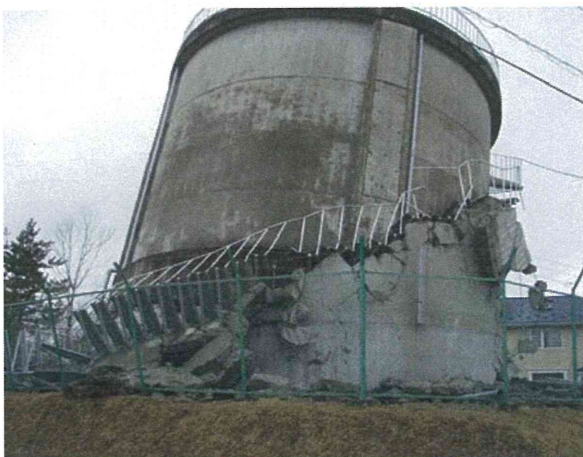
倒壊した高架水槽
