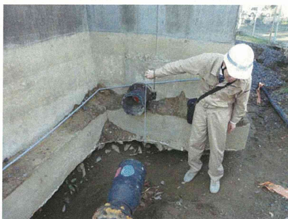
取付部可とう管の破損
