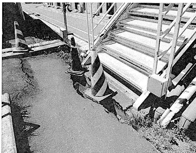
横流式沈澱池 流入側周辺地盤の沈下
