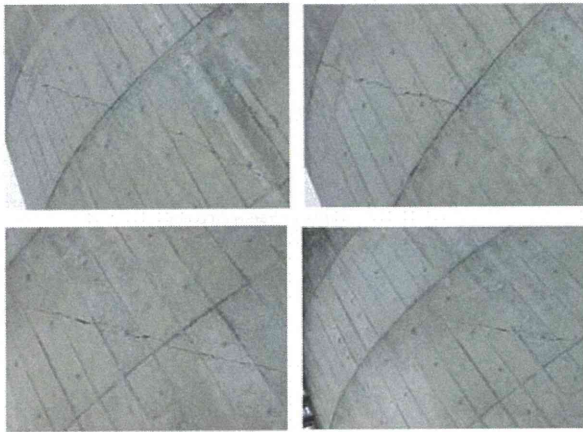
被災状況（3月11日）
