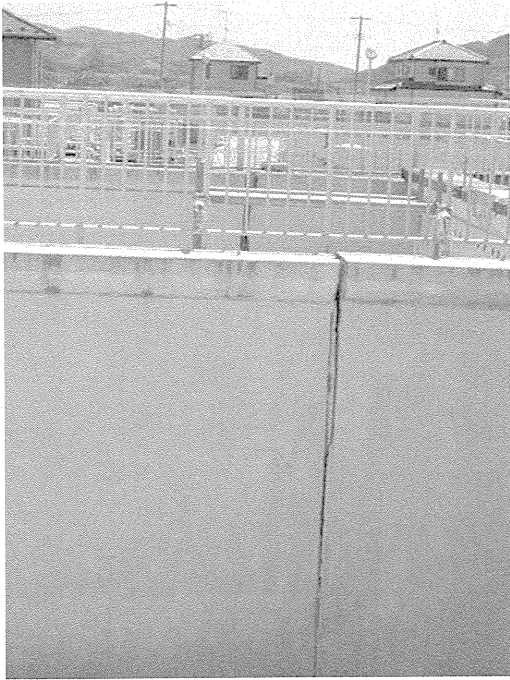
横流式沈澱池 壁面クラック
