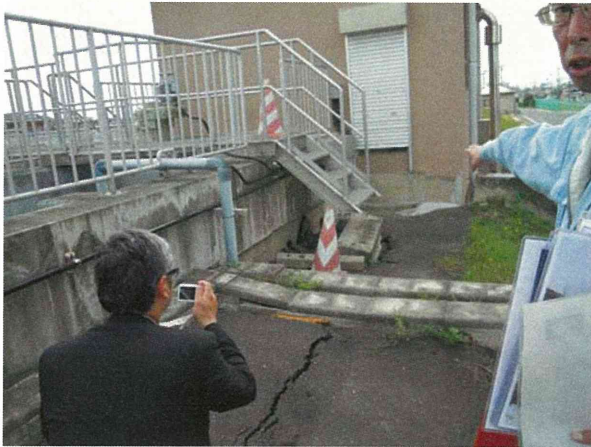
液状化に伴う地盤沈下
