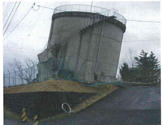
被災状況（4月7日）
