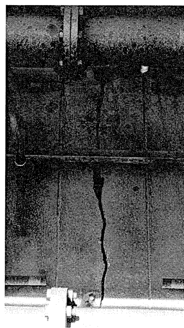
横流式沈澱池 底版クラック
