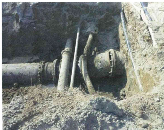
取付部可とう管の破損
