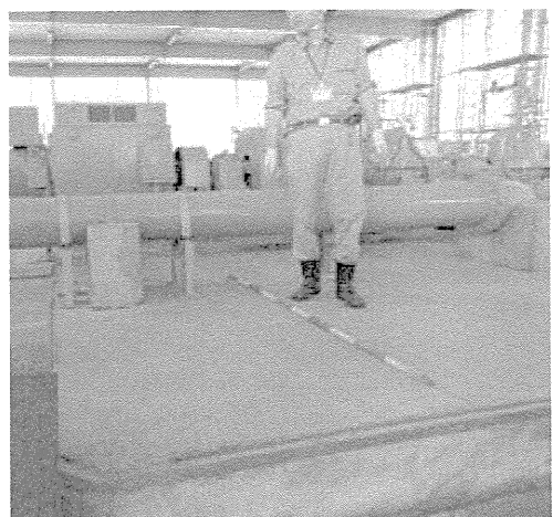
ポンプ下（ポール左側）に空洞が
