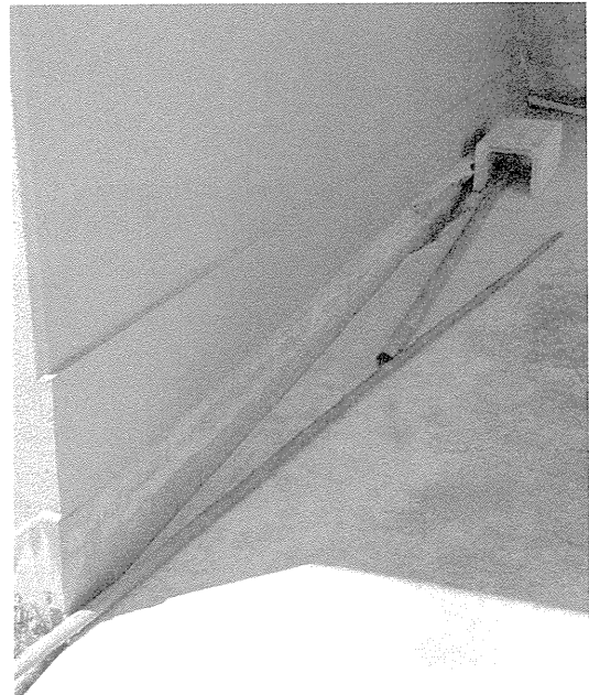
歩廊部 地盤沈下による段差
