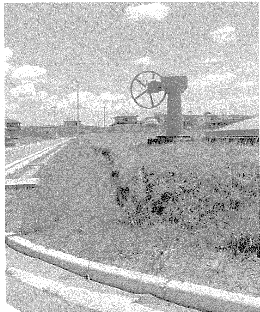
浄水池周辺の地盤沈下
