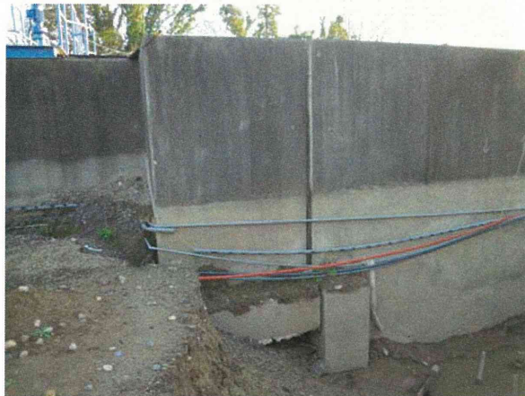
液状化に伴う地盤沈下①
