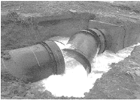
図 1. 大規模な漏水発生時の様子 (宮城県仙南・仙塩広域水道事務所 撮影)
