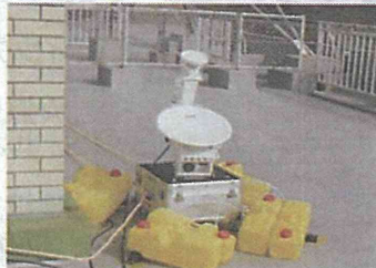
現地対策本部(釜石)に設置された可搬型USATの外観写真(アンテナ径45cm)
