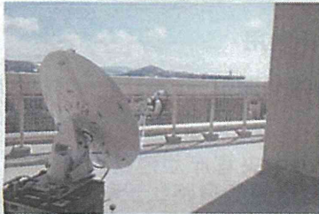
岩手県庁に設置された可搬型VSATの外観写真(アンテナ径1.0m)
