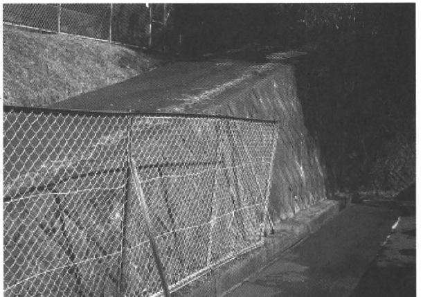
浄水場のフェンスは途中で途切れ、侵入は可能
