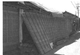
黒島町・角海家の被害状況
