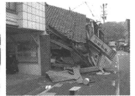
總持寺通り商店街の被害状況
