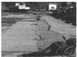
物揚場が隆起、亀裂が入った＝9月、鹿嶋漁港
