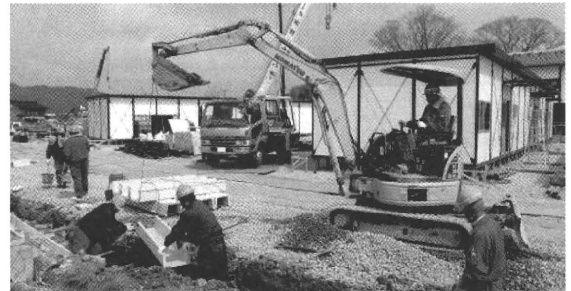
急ピッチで建設作業が進められる仮設仮設住宅=4月、輪島市門前町
