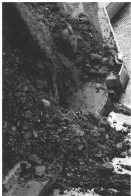
観光名所「鶴ヶ浦」の海岸の壁が崩れ、海岸遊歩道は通行不能になった=3月26日、輪島市輪島港町
