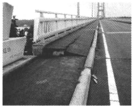
路面亀裂や段差が発生した中能登農道
