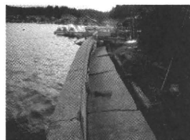
傾斜が生じた海岸護岸=3月27日、穴水港
