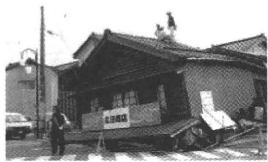
のと鉄道水沢駅近くの商店は、3月25日の本震で前面に大きく潰れ、壁が倒壊する被害で、1店舗部分が倒壊(水沢水町)
