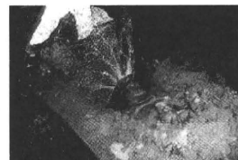
穴水町上水道字留地浄水場系導水管の破損
