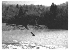
堤体下流側の法面崩壊及び決壊＝9月27日、志賀町管波の平田下池
