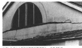
半壊した穴水小学校体育館の屋根部分 = 3月25日
