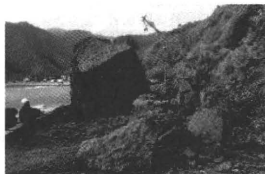
集落に通じる遊歩道に白石が崩落し、輪島市町野町深見地区(左奥)を孤立させた=3月25日
