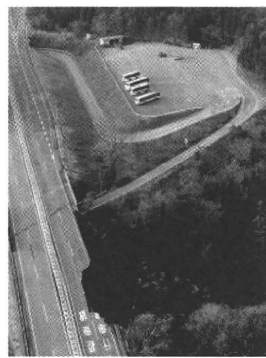
能登有料道路が大きく崩れ落ち、別所岳サービスエリアに取り残された観光バス=3月26日
