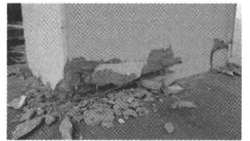
橋脚部元の被災状況 能登島大橋(七尾能登島公園線)
