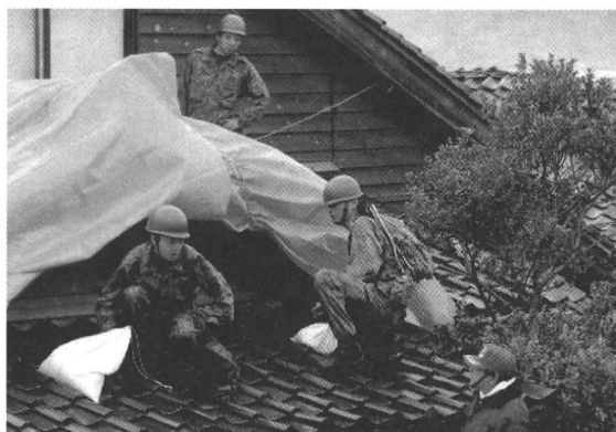
高齢者の多い輪島市門前町黒島町地区では自衛隊員が壊れた屋根にシートをかぶせた＝3月27日
