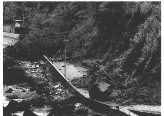
集落に湧く道路に巨石が崩落し、孤立した輪島市前町深見地区。3月26日
