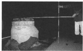
地震の影響で、約90cm以上も隆起したマンホール＝輪島市門前町(市町提供)
