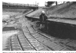
護岸が崩れた輪島市町野町の二級河川ハケ川(はっかがわ)川=3月26日
