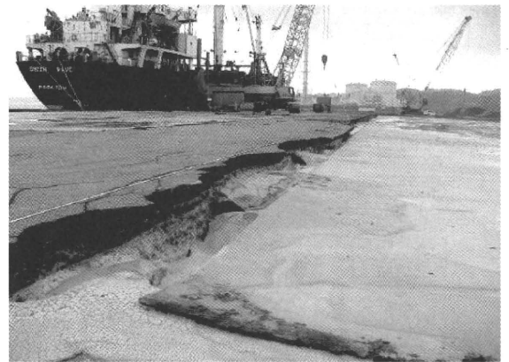
地盤の液状化により、岩盤と土間の間に段差が発生した七尾港大田地区(国土交通省北陸地方整備局提供)
