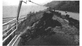
被災状況 輪島市町野町(一般国道249号)=3月25日
