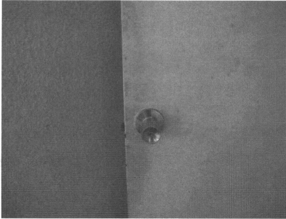
写真 1-6-18 ドアノブの手あか汚れ
