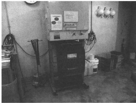
写真 1-6-9 圧縮機 (生ゴミ、一般ごみ)
