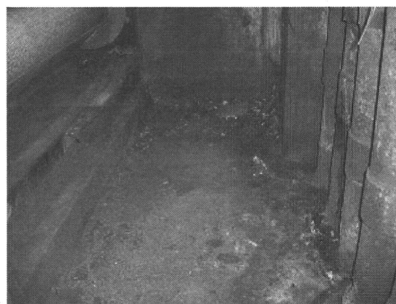
写真 1-2-1 空調機内の汚れの堆積
