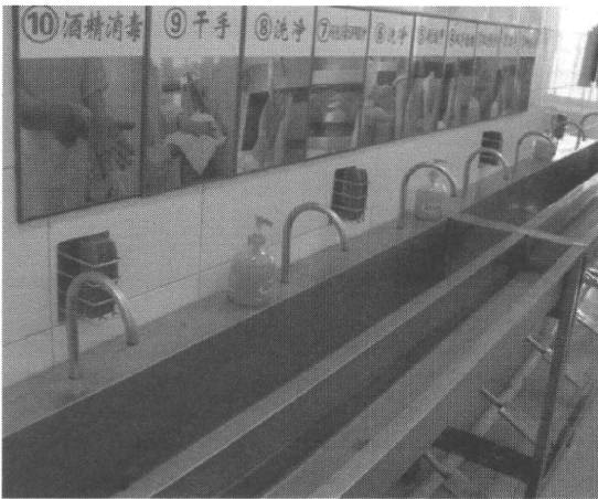
<製造所内入室時の手洗い場所>
