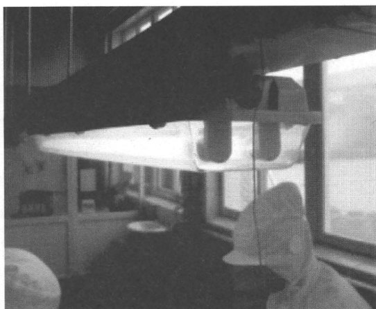
<製造工場内の二重カバー蛍光灯>
