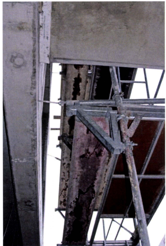
写真5 建物と足場の間隔を撮影したもの（測定したところ0.3m未満であった）
