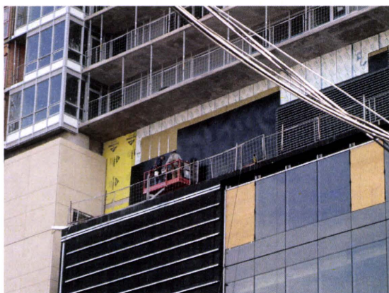
写真26 鉄製支柱を使った墜落防止設備
