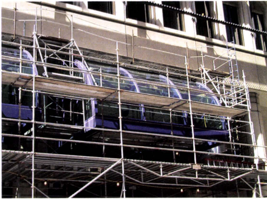
写真 21 2 段手すりを設置したくさび緊結式のシステム足場
