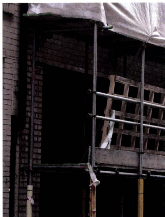
写真 13 妻側に手すりのない足場
