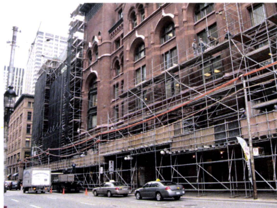
写真29 写真28の親綱がこの足場解体工事で使用されていた (足場最上部で親綱を用いて作業中)
