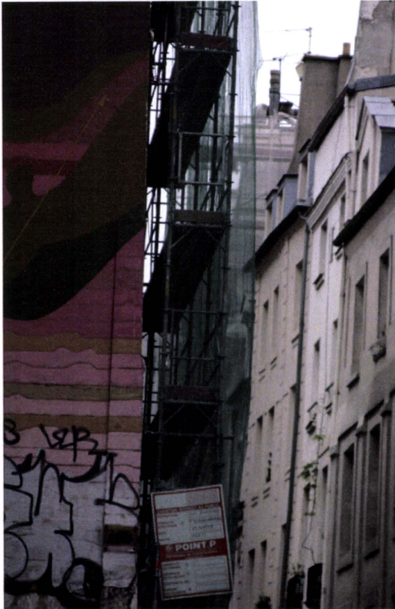
写真 9 足場側面の手すりの設置状況 （同様に 2 段手すりとなっている）
