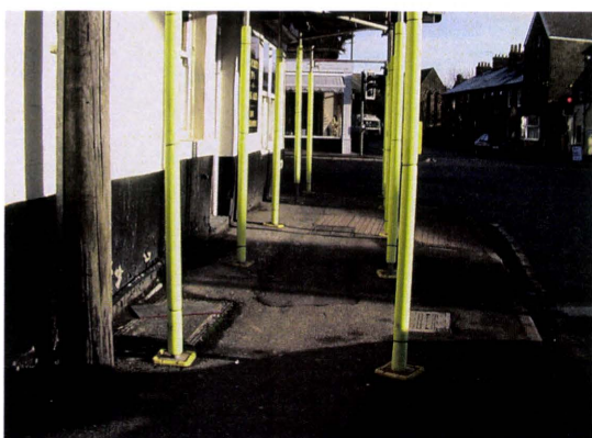
写真 15 根がらみ等のない足場
