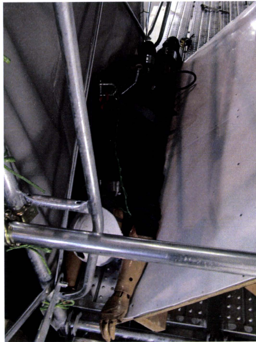
写真 11. 防護膜付メッシュシート (間隔 0mm) の実験後の状況
