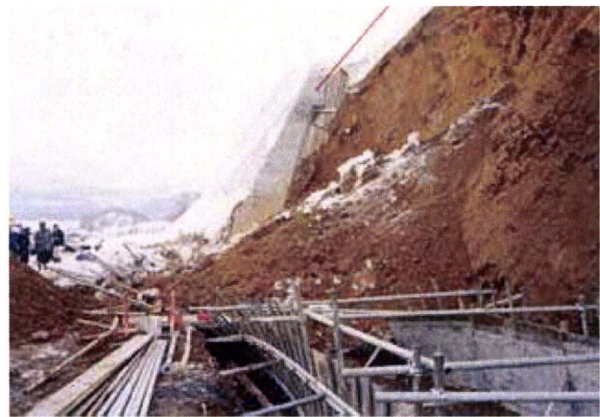
写真-3 型枠施工中の災害事例
