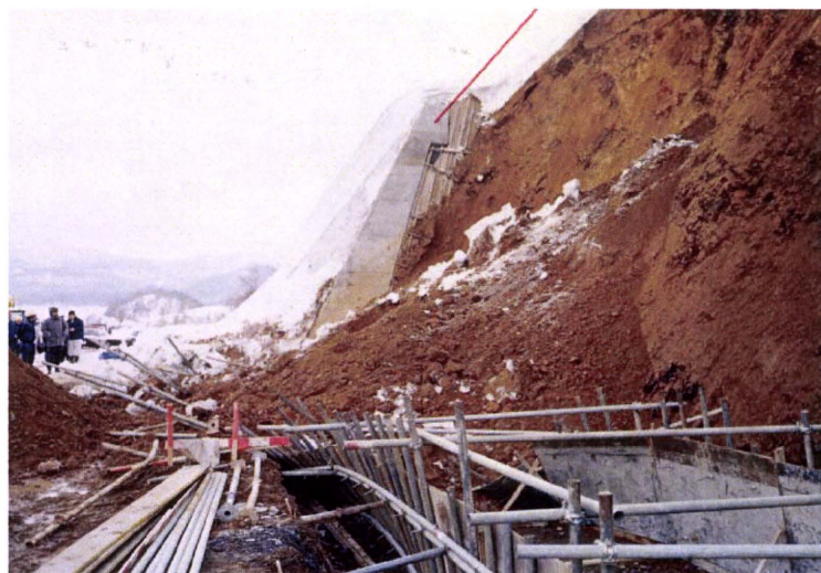
写真-2.2 型枠施工中の災害事例
