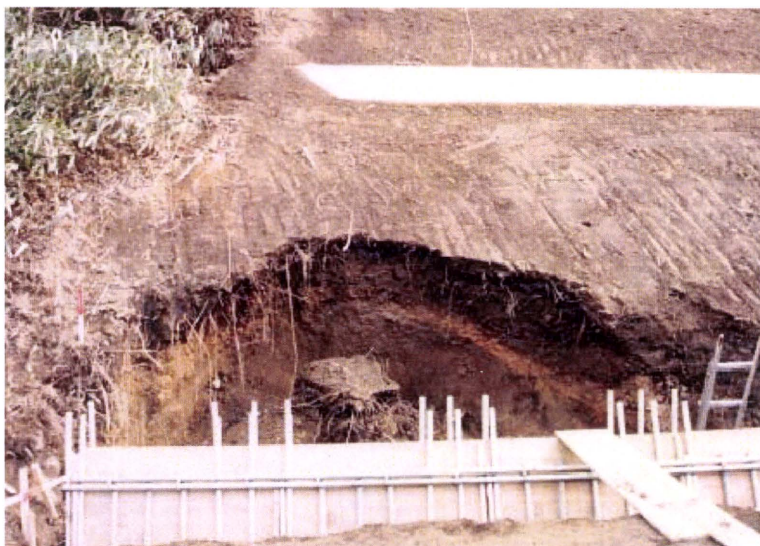
写真-2.1 型枠解体中の災害事例
