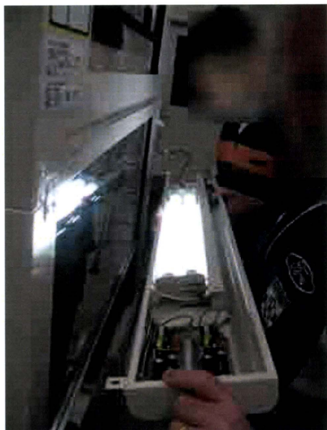
別添 2 9 . 照明フードの確認
