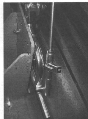
写真16 メカロックと フレームの接触状況
