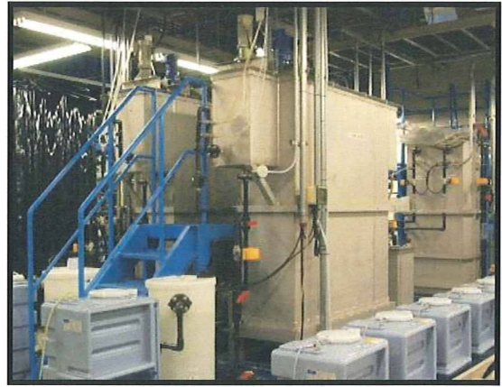
写真2 国立保健医療科学院浄水実験プラント 凝集沈澱槽
