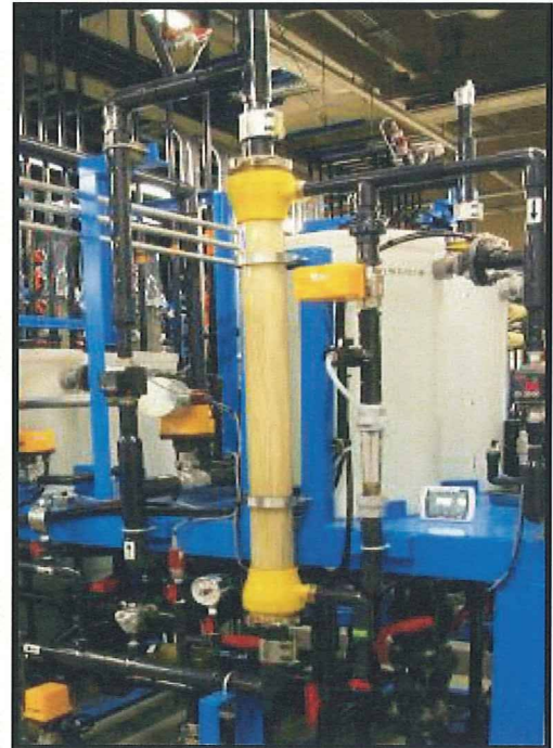
写真4 国立保健医療科学院浄水実験プラント 膜ろ過設備
