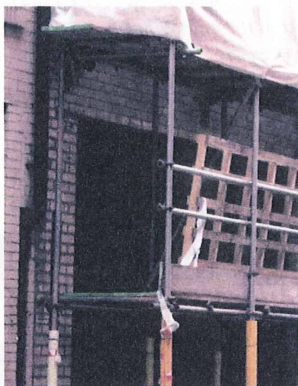
写真 2 妻側に手すりのない足場
