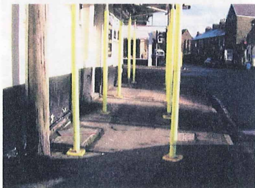
写真 3 根がらみ等のない足場
