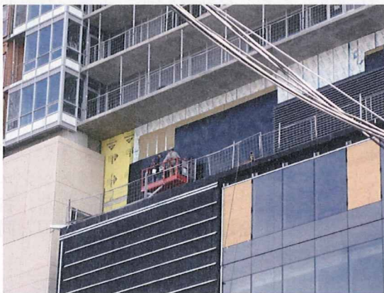
写真7 鉄製支柱を使った墜落防止設備
