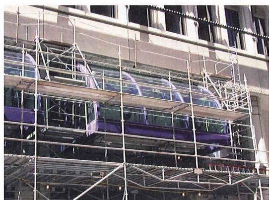
写真2 2段手すりを設置したくさび緊結式のシステム足場
