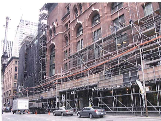
写真 10 写真 9 の親綱がこの足場解体工事で使用されていた (足場最上部で親綱を用いて作業中)
