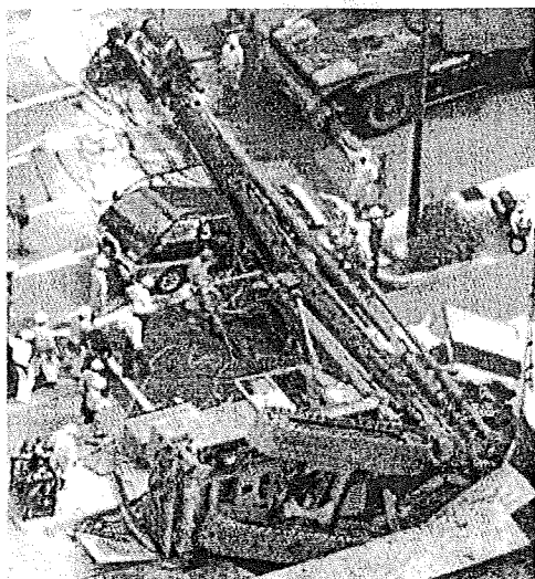
写真1 くい打機の転倒災害
