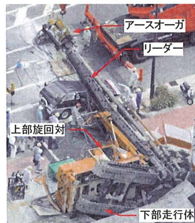
写真1 転倒災害の様子
