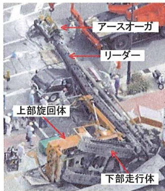
写真1 自走式杭打ち機械の転倒災害
