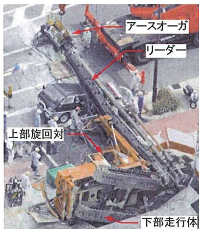
写真1 転倒災害の様子
