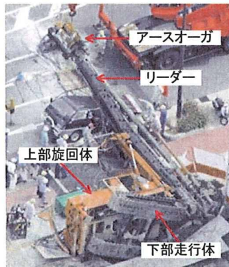
写真1 自走式杭打ち機械の転倒災害
