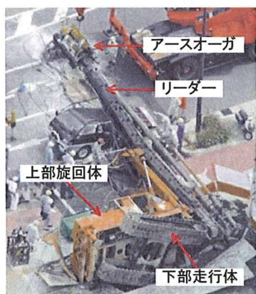
写真1 自走式くい打機械の転倒災害
