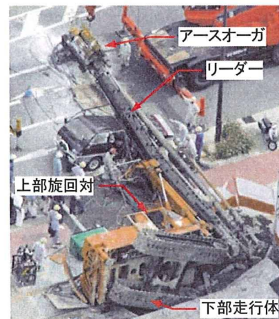
写真1 自走式杭打ち機械の転倒災害
