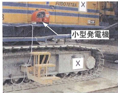
写真 4-5-6 車載した小型発電機
