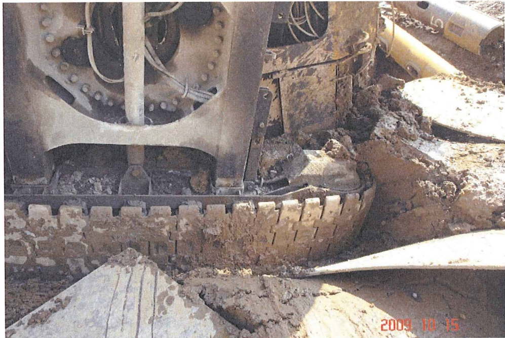
写真 2-2-5 沈下部周辺に見られた軟弱な地盤
