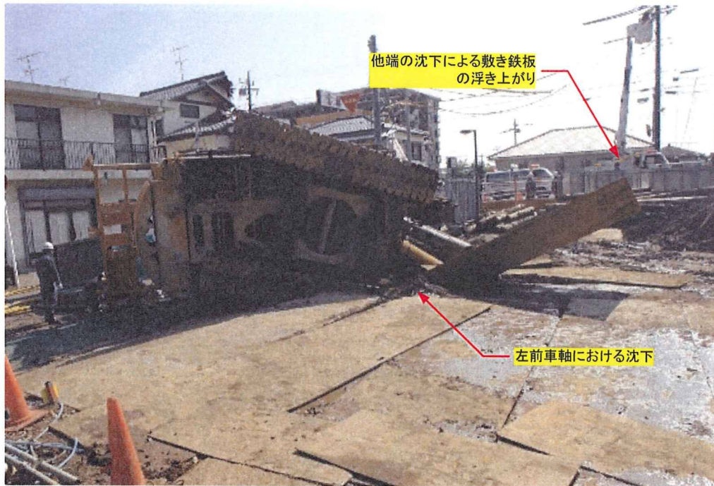
写真 2-2-3 転倒直後のくい抜機を後方から見た様子
