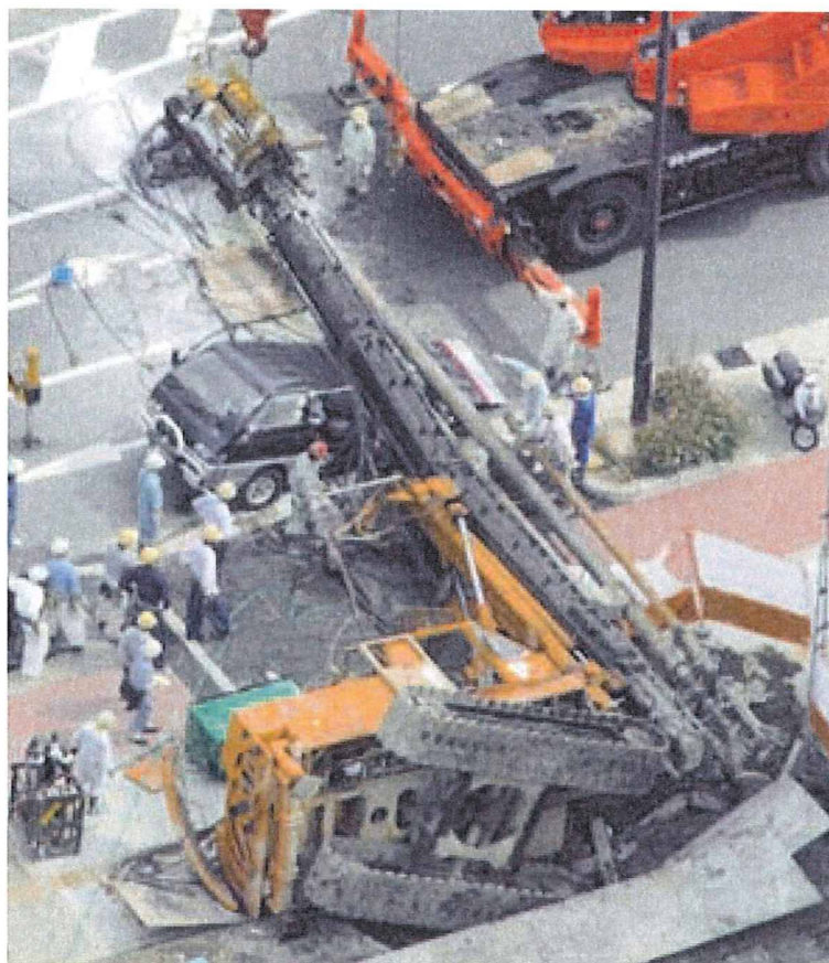
写真 2-1-1 2002(平成 14)年に発生したくい打機の転倒
