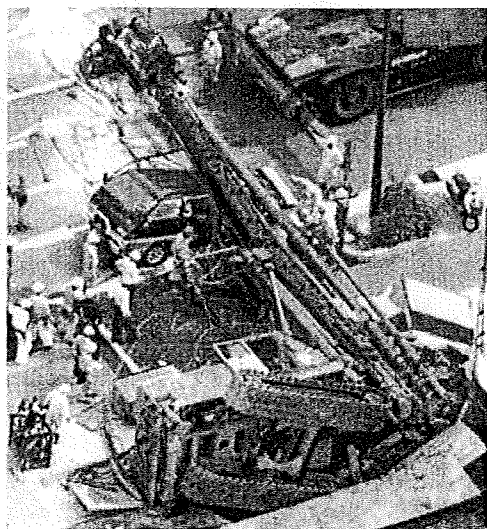
写真1 くい打機の転倒災害
