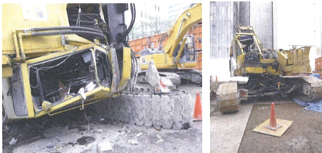
写真 2-3-1 損傷した運転席の様子(左：転倒直後の様子、右：検証時の様子)
