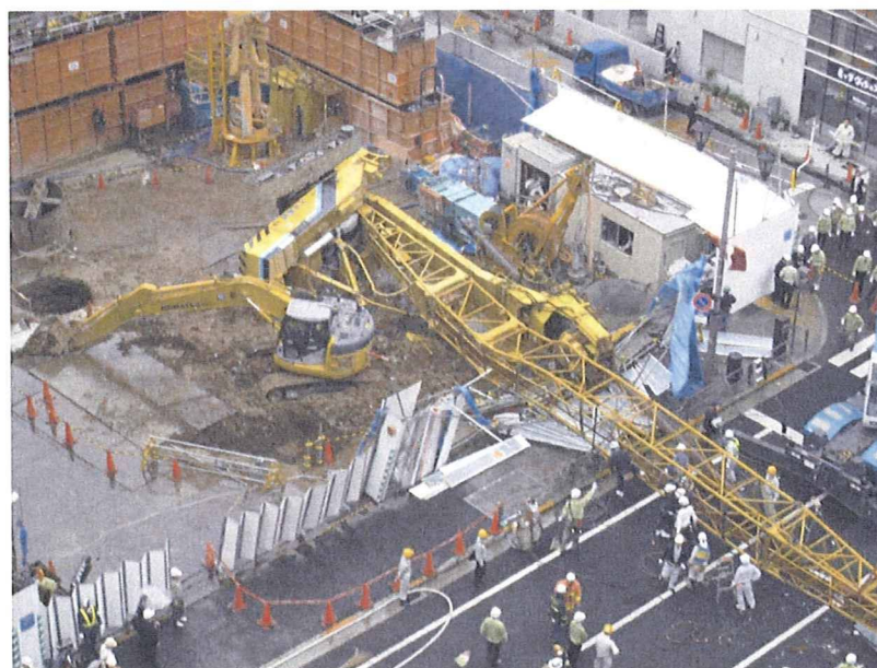
写真 2-1-2 片側のクローラが大きく沈下して転倒した様子
