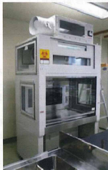
図3. クラスII生物学用安全キャビネットの 設置環境
