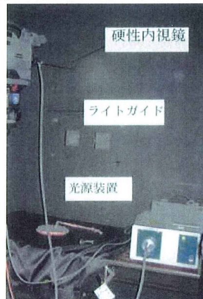
図1 従来の照明システムの実装状態
