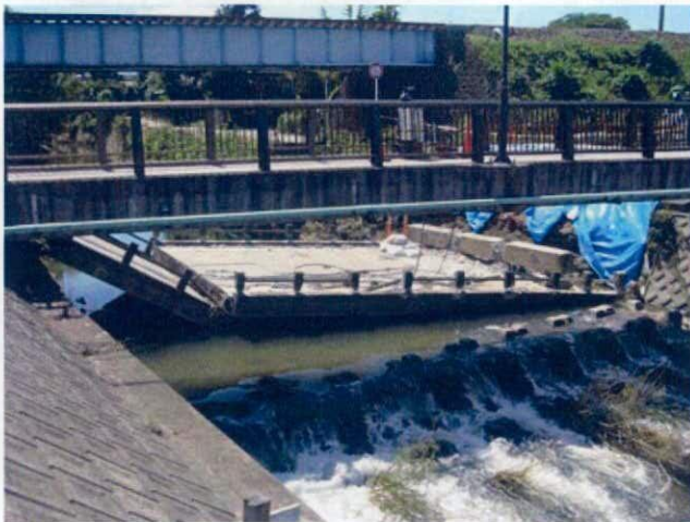
崩落した橋梁（竜泉寺川、菘川新町）
