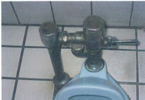
（写真5）衛生金具の腐食
