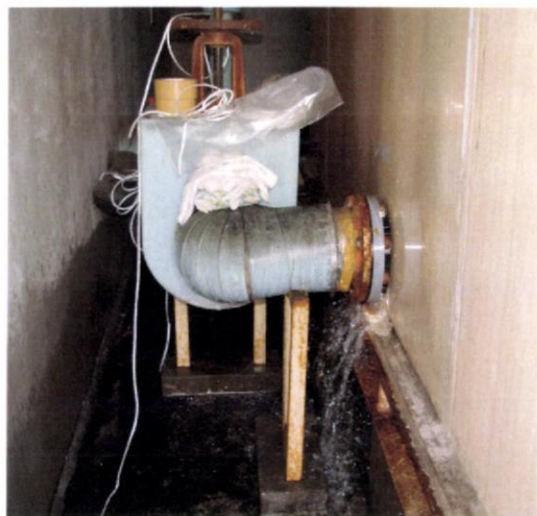
震災被害による漏水の一例
