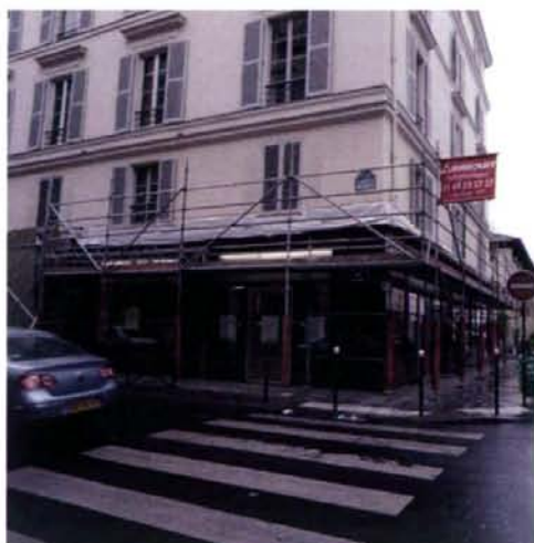
写真8 手すりの設置状況（複数の手すりがくさびの部分で設置されている）
