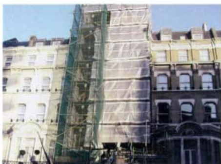
写真 16 足場用シートの設置状況 (日本のようにピンと張っていない)
