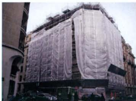
写真10 足場用シートの設置状況 (日本のようにピンと張っていない)
