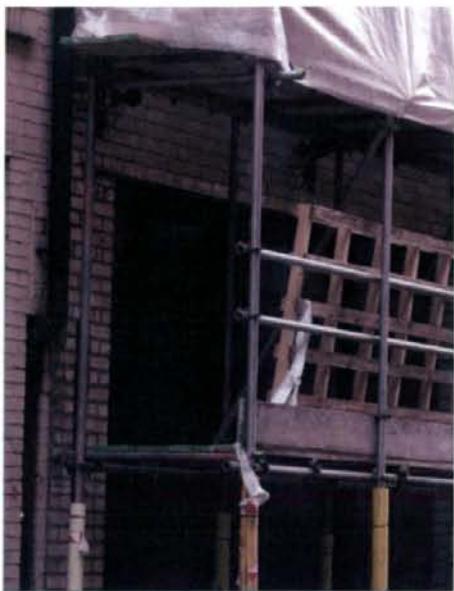
写真 13 妻側に手すりのない足場
