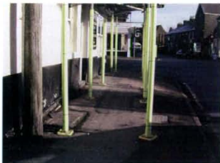
写真 15 根がらみ等のない足場
