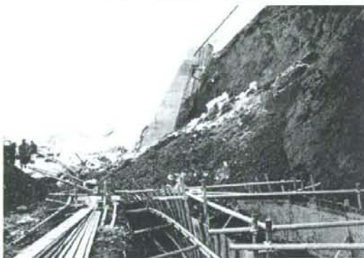
写真-3 型枠施工中の災害事例
