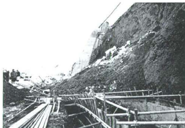
写真-2.2 型枠施工中の災害事例
