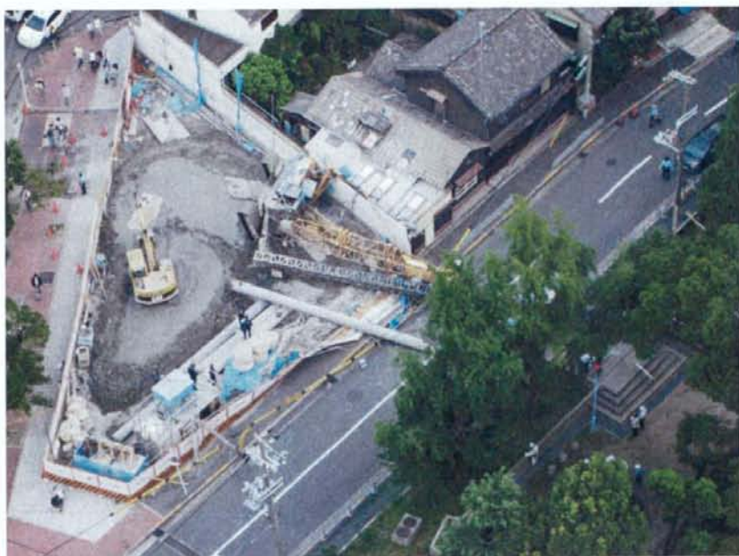
写真 2-1-1 災害現場を上空から見た様子
