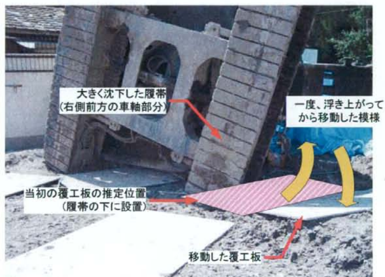
写真 2-1-5 履帯の沈下によって移動した覆工板
