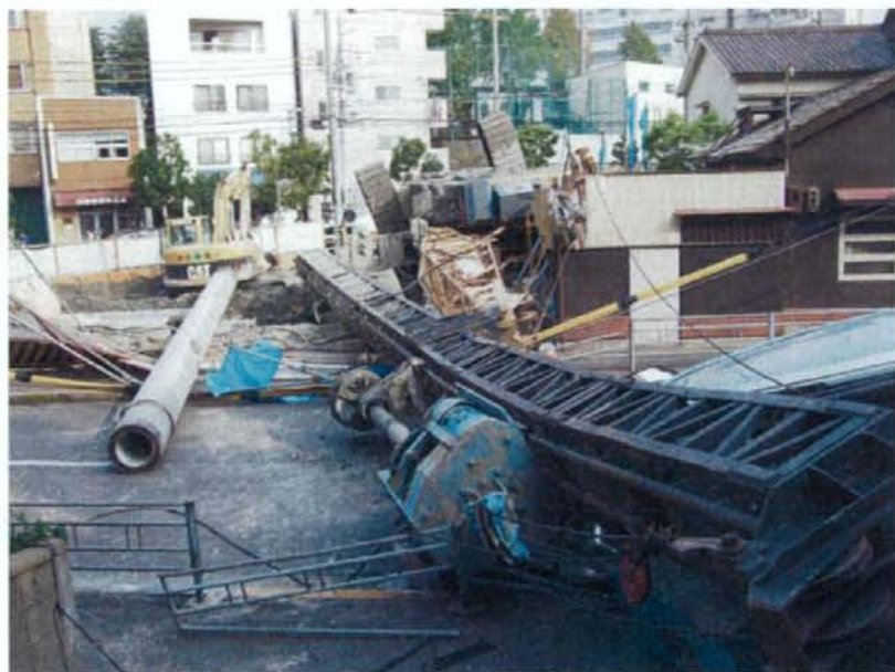
写真 2-1-3 転倒したくい打機のリーダーが道路をふさいだ様子
