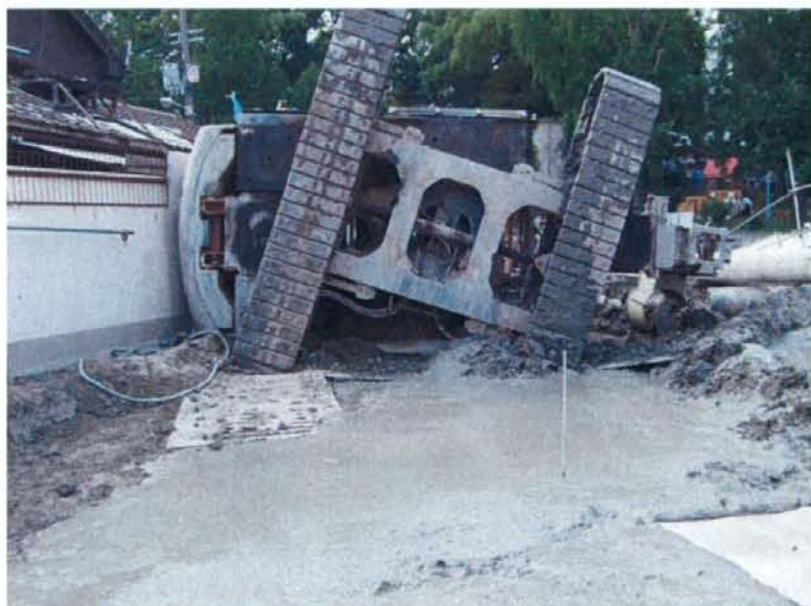
写真 2-1-2 片側のクローラが大きく沈下して転倒した様子
