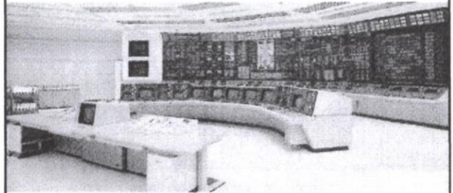
第三代原子力発電プラント中央制御盤
