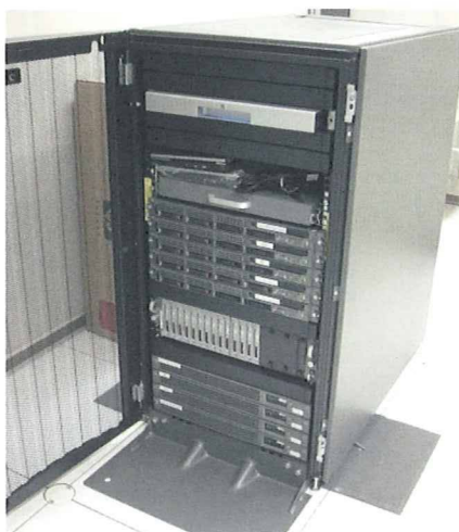
図 3.3 マシン室内設置機器 (各サーバ等)
