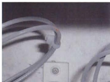
図 B-2-1 凍結により破損したケーブル (平成 18 年度)
