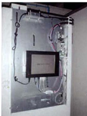
図 C-3-2 操作パネル内部
