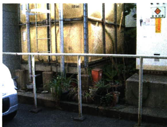
写真 6 周囲に植木鉢の置かれた受水槽
