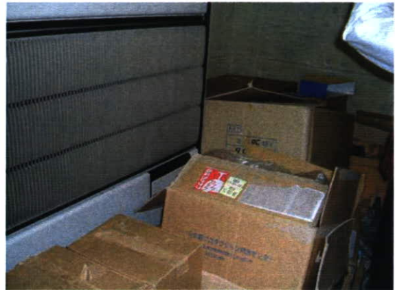
写真 2 物置化した空調機室
