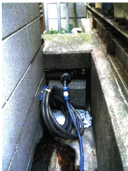
写真 10 ホースがとりつけられたままの散水栓
