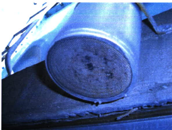
写真 11 破損しているオーバーフロー管防虫網
