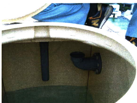
写真 8 吐水口空間のとれていない高置水槽
