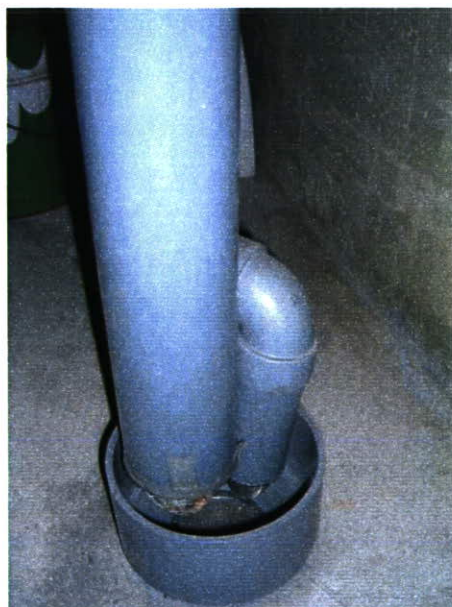
写真 9 排水口空間のとれていない受水槽
