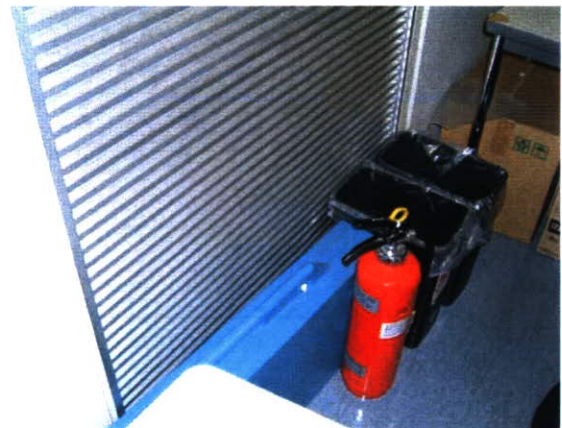
写真 4 還気口前の障害物
