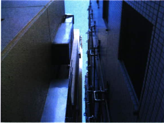
写真 1 外気取入口と排気口の接近
