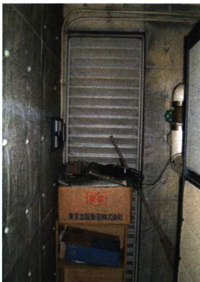
写真 3 空調機室の還気口前の障害物
