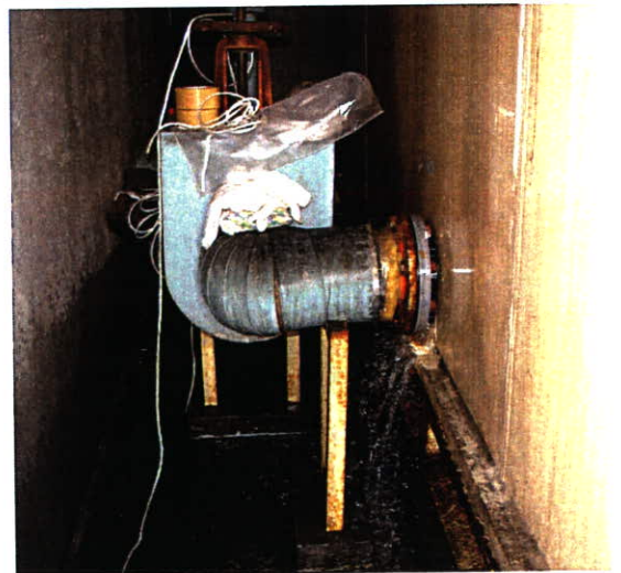
震災被害による漏水の一例
