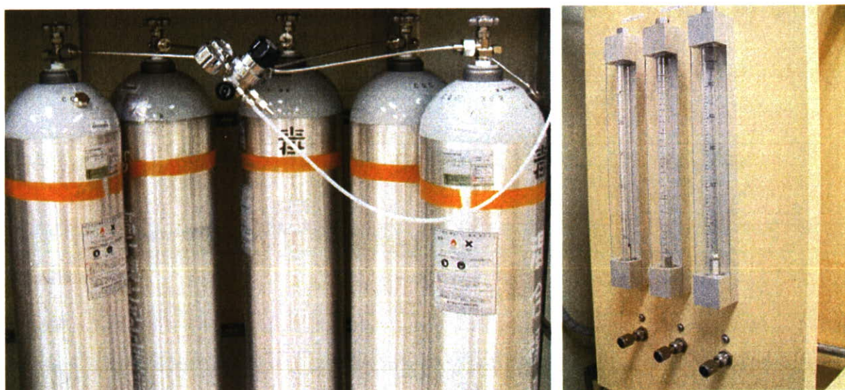
Photo. 7 ホルムアルデヒド標準ガスボンベ (高千穂商事) 5本の連結配管とボンベ用に新設した流量計(柴田科学)
