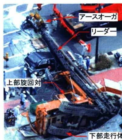
写真1 自走式杭打ち機械の転倒災
