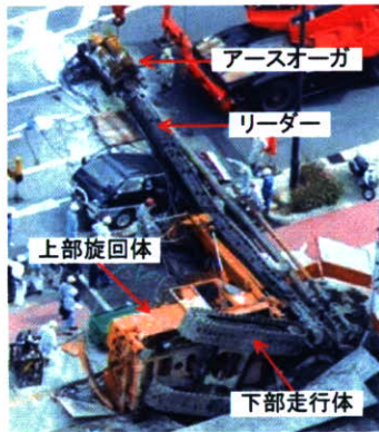
写真1 自走式杭打ち機械の転倒災害
