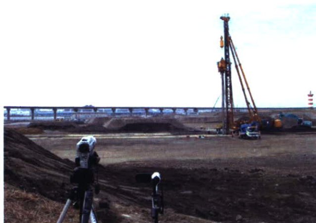
写真 3-5-7 ビデオカメラの設置状況
