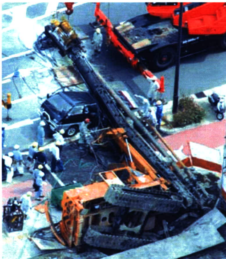
写真 2-1-1 2002(平成14)年に大阪市内で発生した杭打ち機械の転倒
