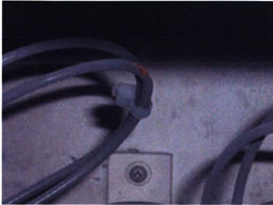
ケーブルの被覆が剥がれた部分
